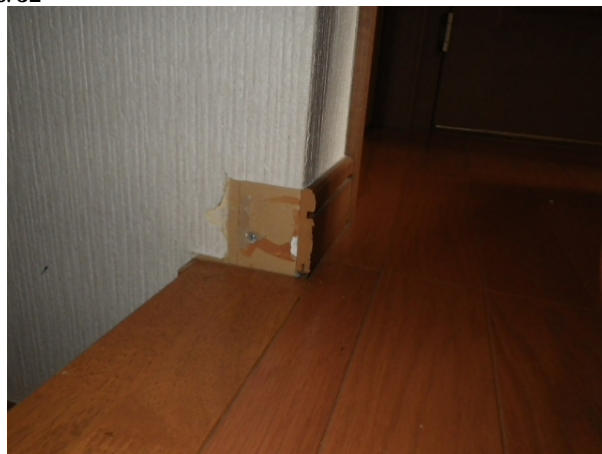
床 > 仕上げ材表面 > フローリング等 > 剥がれ
