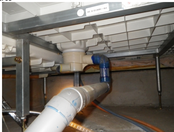
排水設備 > 排水管 (建物内)
