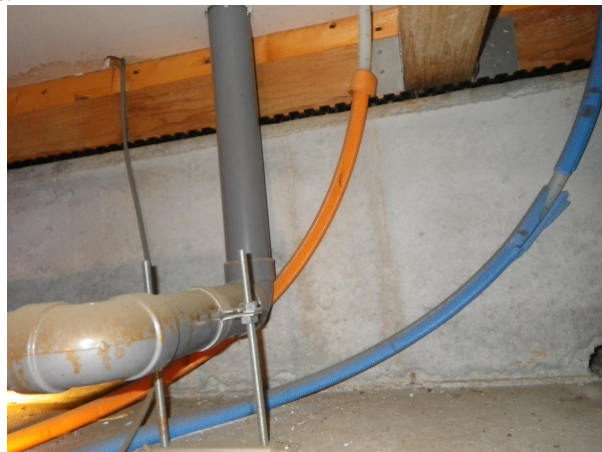
排水設備 > 排水管 (建物内)
