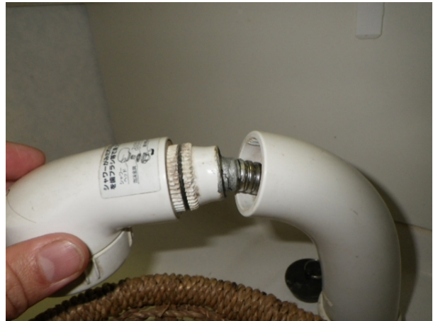
給水設備 > 漏水
