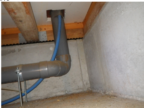
排水設備 > 排水管（建物内）
