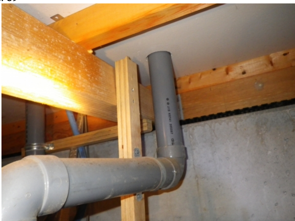
排水設備 > 排水管 (建物内)
