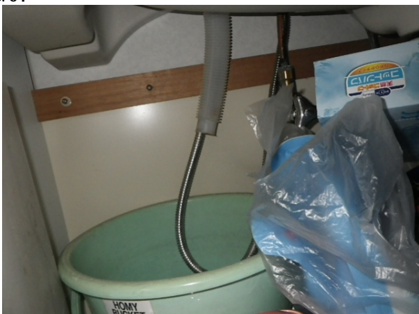
給水設備 > 漏水
