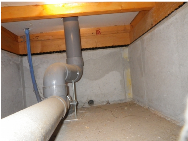
排水設備 > 排水管 (建物内)
