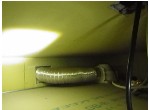
換気設備 > ダクト
