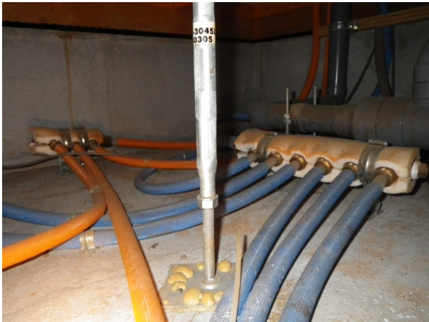
給水設備 > 漏水
