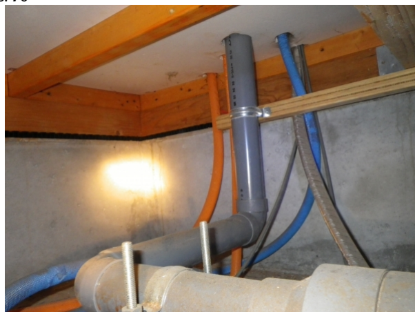
排水設備 > 排水管 (建物内)
