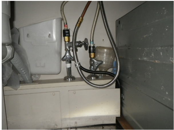
排水設備 > 排水管（建物内）
