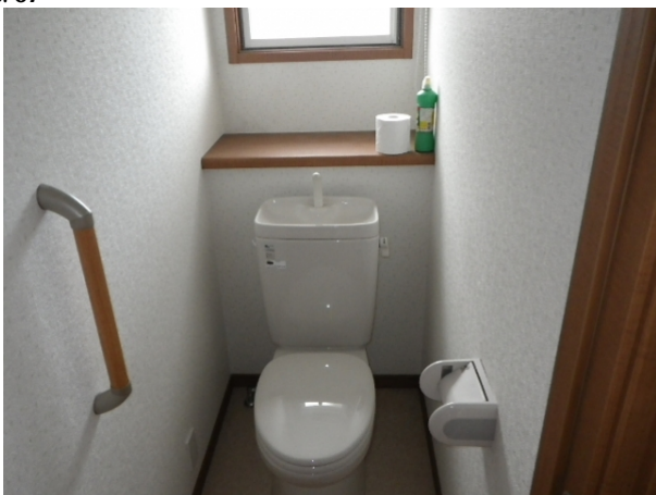
排水設備 > 排水管 (建物内)
