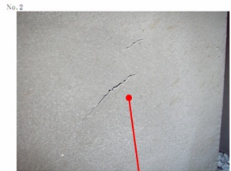
基礎 > 基礎表面 > モルタル仕上げ > 浮き 基礎表面のモルタル仕上げにひび割れが見られ、その周りに浮きが見られました。ひび割れは基礎コンクリートまで至っておらず、モルタル仕上げ部分だけのものと思われます。
